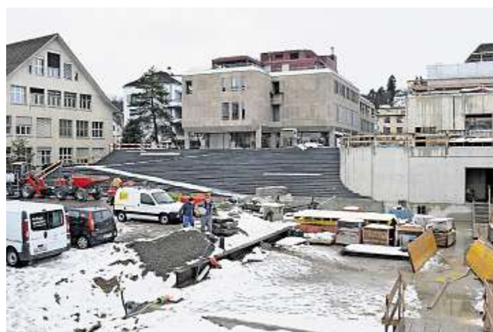
Der Dorfplatz in Meilen ist noch eine Baustelle. Am rechten Bildrand ist der Rohbau des Pavillons zu sehen.
