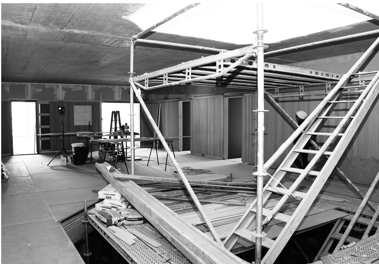
Im Vordergrund die achteckige Öffnung des Atriums, hinten die Eingänge zu den Büros. Die Wände sind mit Eichen-Furnier verkleidet. Fotos: MAZ
